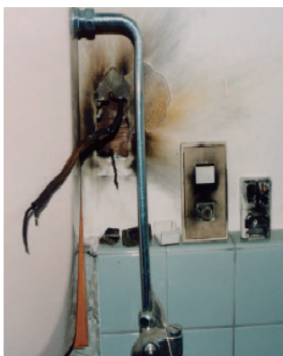
被害例:コンセント
